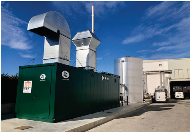
Cogenerazione a gas naturale
