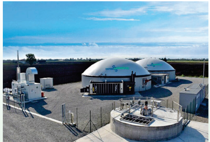
Cogenerazione a biogas/biometano
