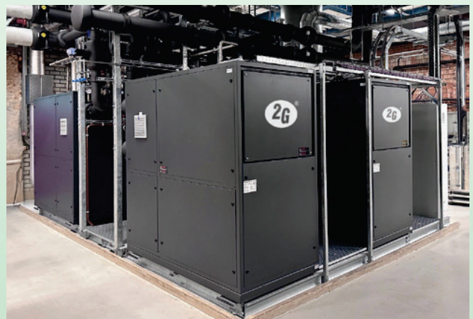
Pompe di calore
