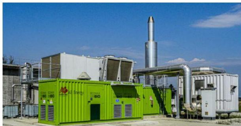
L'infrastruttura per la trasformazione delle biomasse in energia dell'impianto
