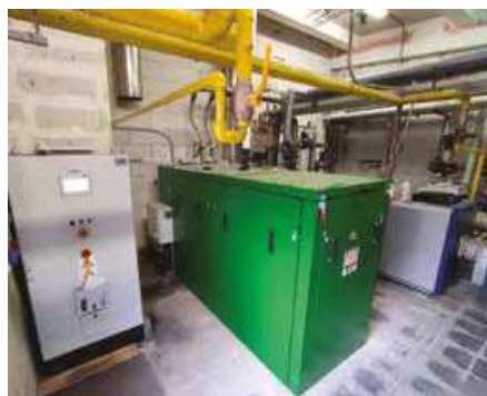
L'IMPIANTO PORTA A UNA RIDUZIONE DEI CONSUMI ENERGETICI TOTALI DI CIRCA 30%
