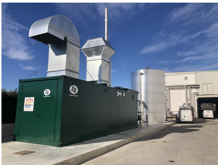
Foto: cogeneratore 2G installato presso Faccia F.Ili
