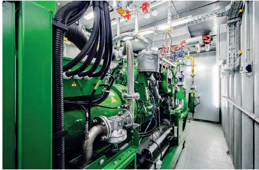
Bild 1. Wasserstoff-BHKW Agenitor 406 im Betrieb
