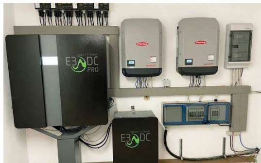
Ein Batteriespeicher garantiert in Kombination mit BHKW und Solar eine nahezu autarke Versorgung
