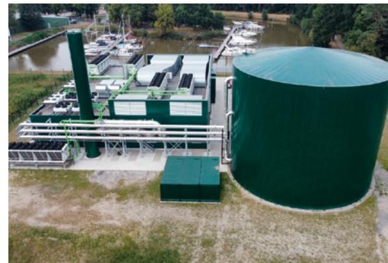
In Papenburg wurde 2024 der erste Green Cube installiert: Ein KWK-Kraftwerk mit Wärmepumpen und Wärmespeicher.
