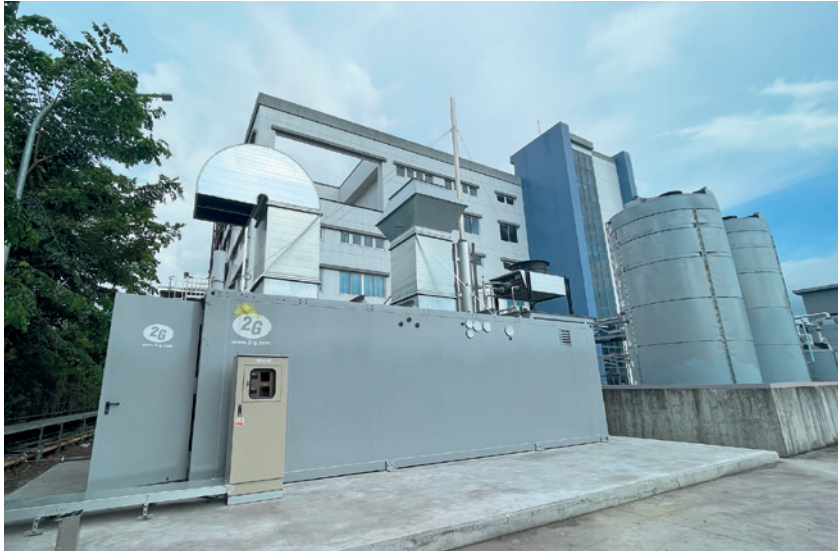
Bild 3. Sowohl der Motor und die Hydraulik als auch die komplette Steuerungseinheit wurden in einem maßgeschneiderten Container geliefert
