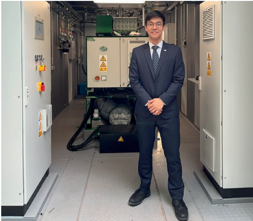
Bild 1. Andrew Lee von AM-Power hat die Installation des Projekts vor Ort geleitet
