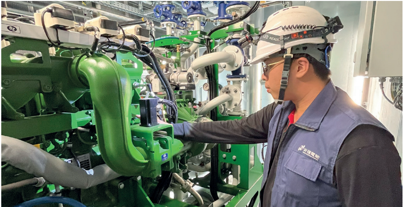
Wasserstoff, der ein Nebenprodukt eines Recyclingprozesses ist, wird in diesem BHKW zur effizienten Erzeugung von Strom und Wärme genutzt
