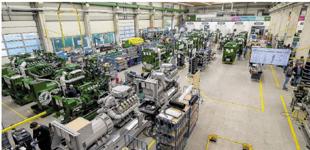
In der 3000 Quadratmeter großen Montagehalle bei 2G wird in drei Produktionslinien gearbeitet. FOTO MARKUS GEHRING
