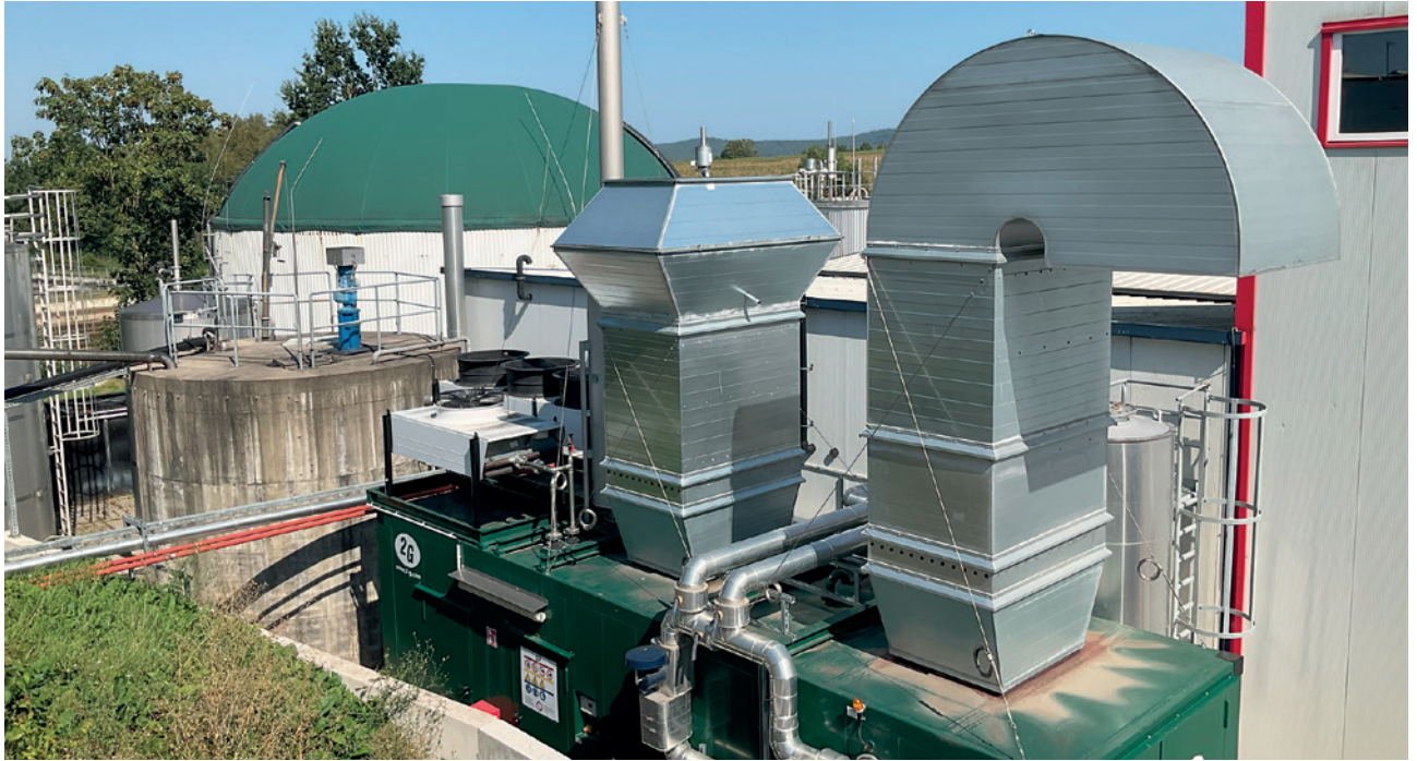
Eine Biogasanlage und ein BHKW gehören zum ausgeklügelten Energiekonzept für die Produktion von Knabbergebäck
