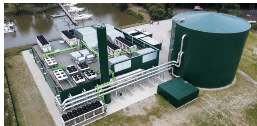
Das Projekt „Hafenwärme Papenburg“ wurde quasi auf der grünen Wiese umgesetzt
