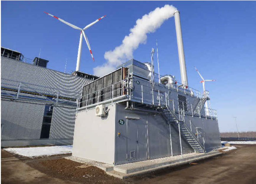
Bild 2: Kompakte BHKW-Zentrale. Foto: 2G Energy AG
